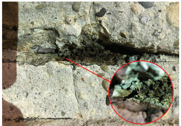
Fig. 2: Wood debris embedded at pour joint interface
